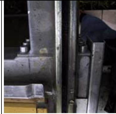
Hier sind die 3m langen Träger der Laufschiennen am Stahlskelett des Gebäudes angeschraubt. Die Laufschiennen selbst sind 5,4m lang
